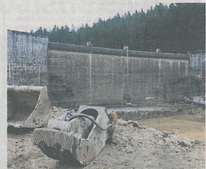
La seule vidange du barrage depuis 1957 avait été effectuée en 2005. Elle avait laissé apparaître d'importantes dégradations, nécessitant le percement de l'édifice. Photo Philippe Vacher
